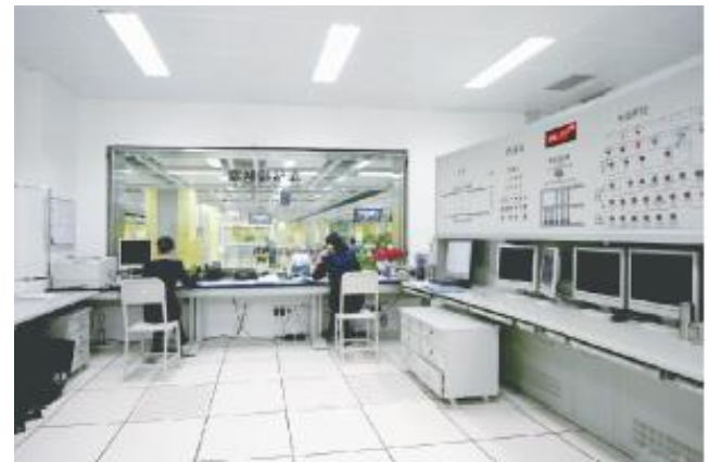
图 2-11 某地铁车站控制室
